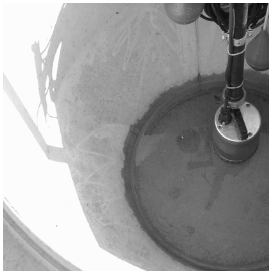
Bild 1: Pumpenschacht Neutra Plus
